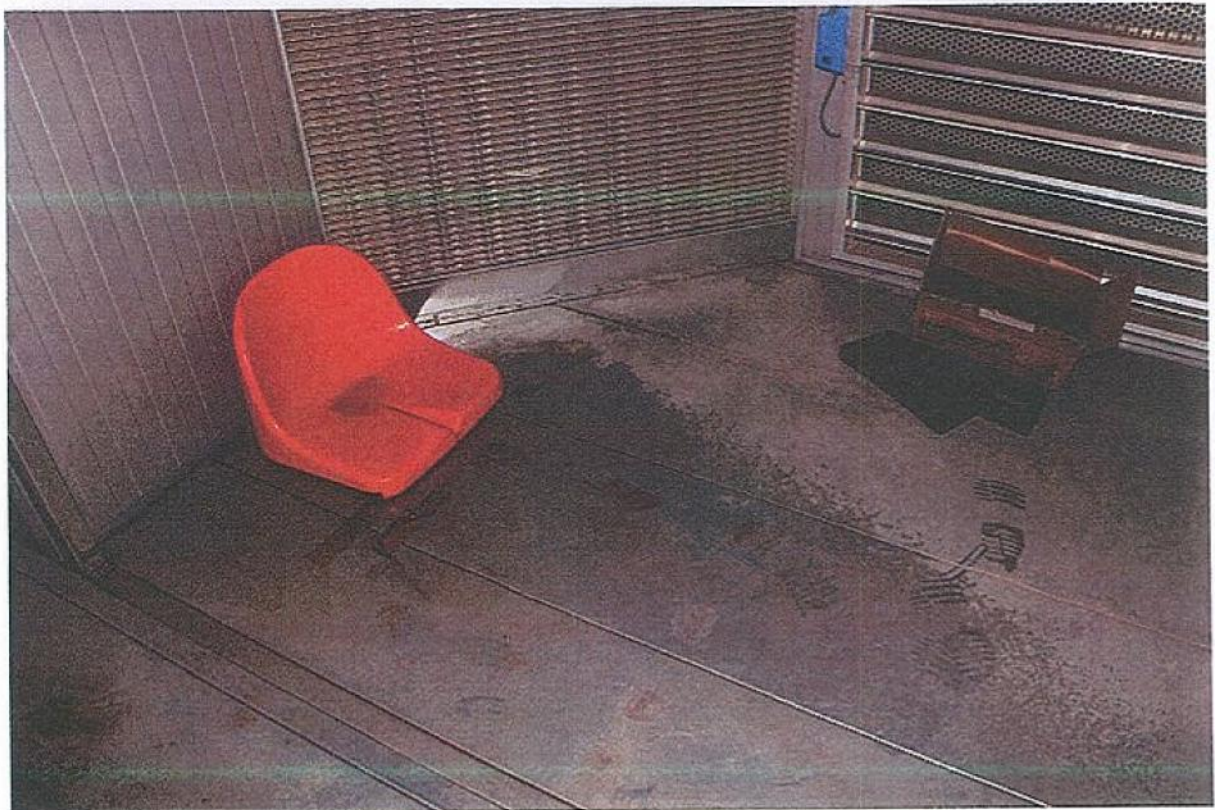
INTERIOR REFRIGERADORA. INSTALACIONES CON ÓXIDO EN TODO EL HABITÁCULO.
