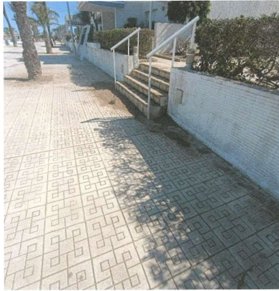
Falta de accesibilidad
